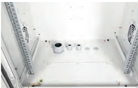
Entrée de câbles dans le plancher
